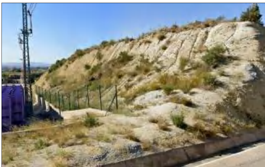
Aspecto del talud afectado por la Modificación nº 1
